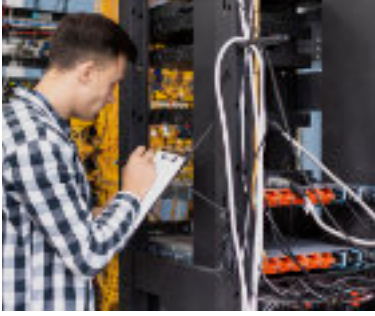
IT panolarında, Server rack kabinlerinde,
