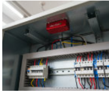
Elektrik kabinleri, kablo kanalları ve sayaç kutularında
