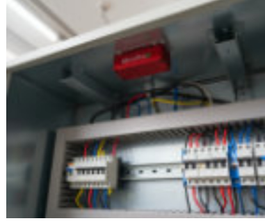
Elektrik kabinleri, kablo kanalları ve sayaç kutularında
